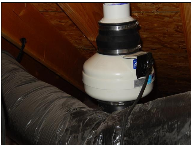
8.3 Item 5(Picture) Radon vent fan
